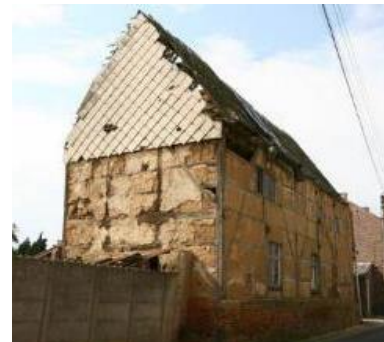
Figuur 16 De zestiende-eeuwse Sint-Petrushoeve was het oudste bouwwerk van Attenhoven. Na lang verval stortte in mei 2008 de hoeve uit lemen vakwerk definitief in. In 2010 kocht het Landense stadsbestuur het monument aan om het te renoveren.
