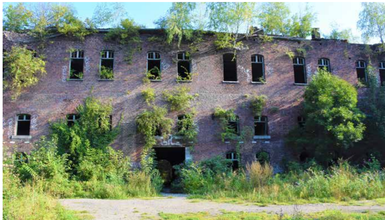
Fig.19: Ook de overblijvende gebouwen zoals dit oorspronkelijke kazernegebouw komen meer in verval. © David Maes Simon Stevin V.V.C.
