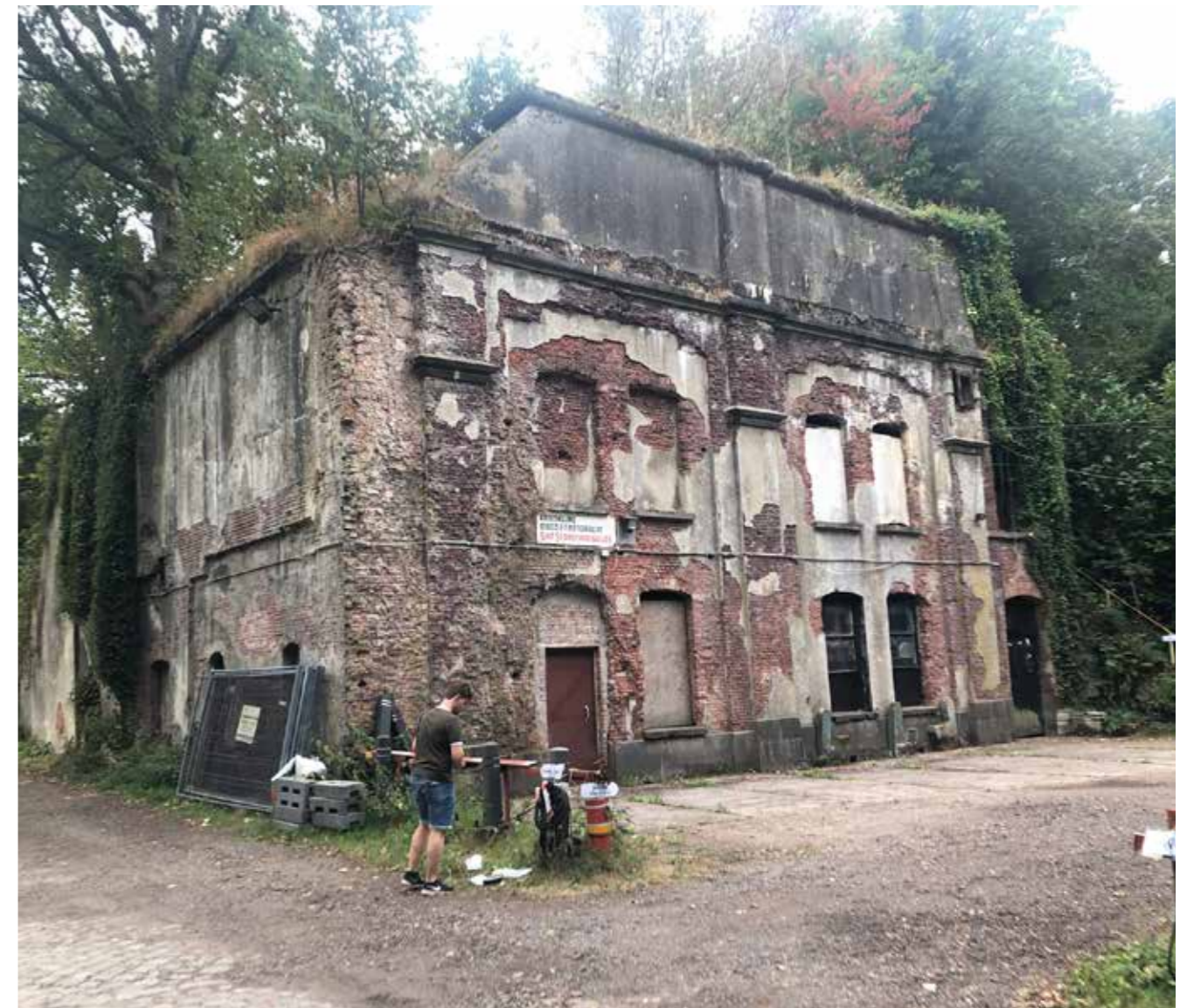
Resterend gedeelte van het officierengebouw met rechts de schade van de Duitse beschieting WO1
