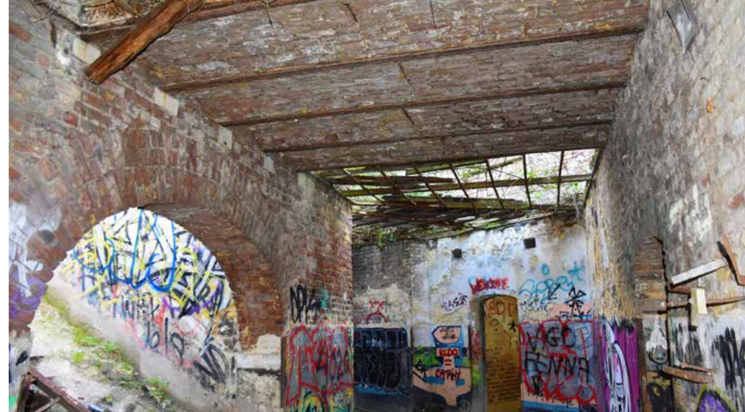
Fig.26: Het dak is ten dele ingestort als gevolg van een brand. © David Maes Simon Stevin V.V.C.
